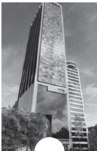
Secretaria de Economia CDMX Instalación Filtro Solar Mod. 4100 PhiFer
