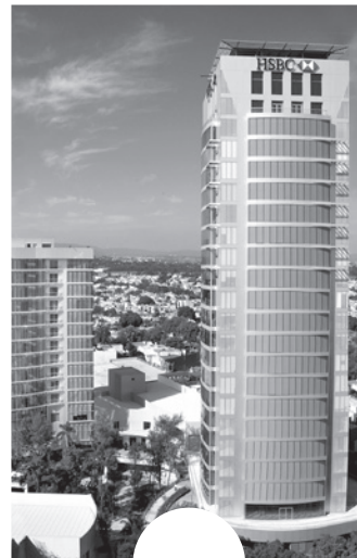
HSBC GDL Instalación Filtro Solar Mod. 2000 PhiFer
